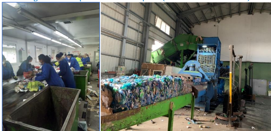
Figura 4-11 Stația de sortare Timișoara (linia de sortare manuală)
